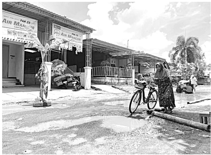
PROTES: Kondisi jalan rusak di Desa Kayen yang viral ditanami pohon pisang oleh warga sekitar karena membuat beberapa pengguna jalan terjatuh.
